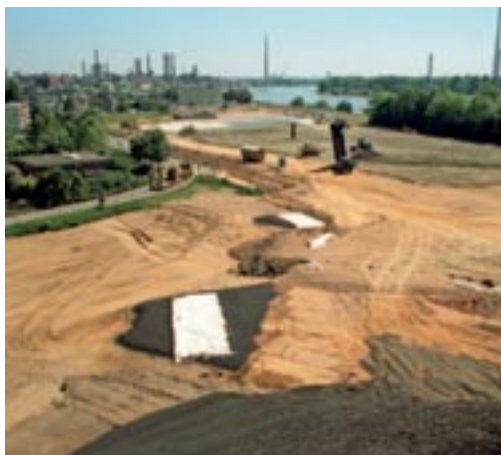
Bodenluft-Sammel- rigolen an der Bauabschnittsgrenze (Bild von Juli 1996).
