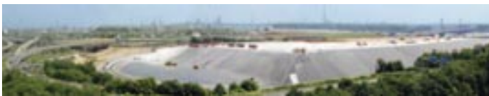
Der Bereich innerhalb des Autobahnkreuzes Leverkusen-West wird großflächig mit Kunststoffdichtungsbahnen (Flachbereiche) und Asphalt (Böschungen) abgedichtet.
